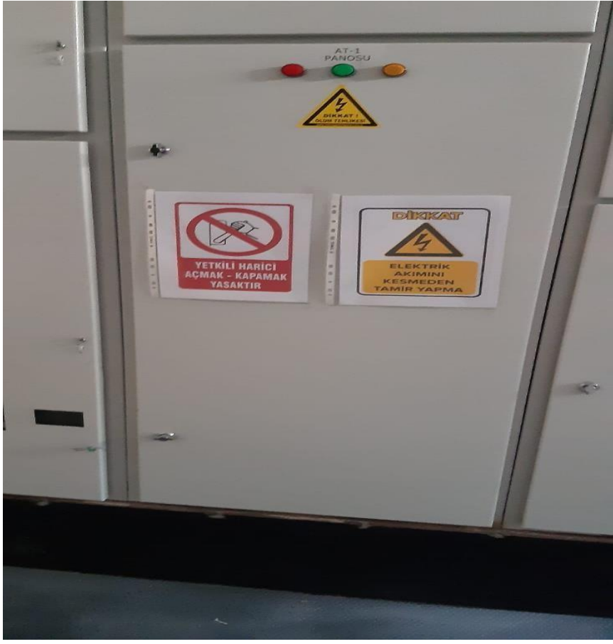
ENERJİ ODAMIZDAKİ GÜVENLİK LEVHALARI
