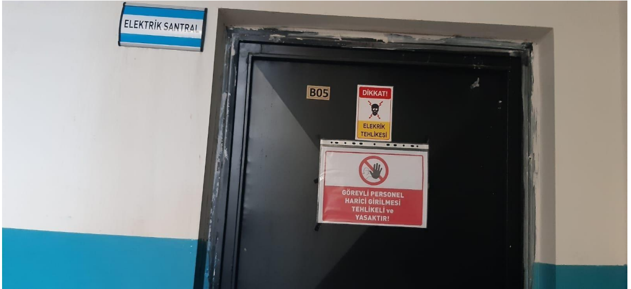
ENERJİ ODAMIZDAKİ GÜVENLİK LEVHALARI
